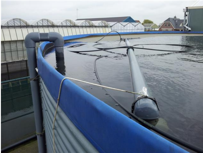
Foto: Werken met een aparte silo kan voordelen bieden
